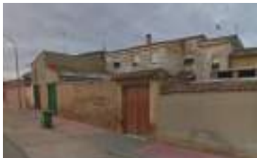
Edificaciones en estado de ruina, Paredes de Nava
